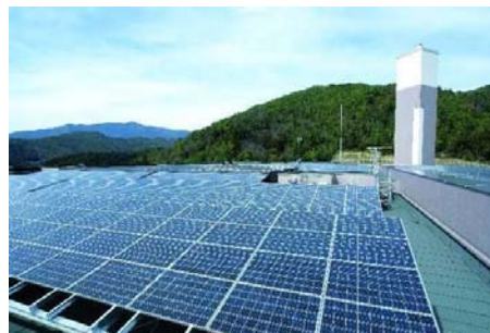
太陽光パネル
