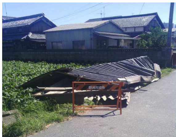
【平成 25 年台風 18 号の被害状況】
