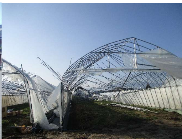
【平成 29 年台風 21 号の被害状況】
