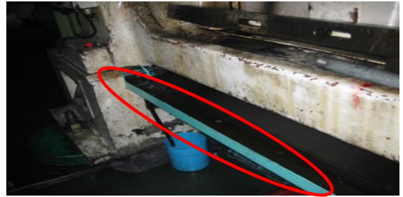
プレス機側面に油受を取付け油の落下を防止
