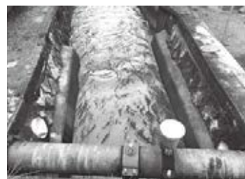
妓王井川の改修を要する箇所の一例
