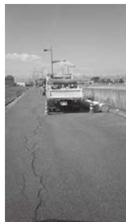
市三宅・妙光寺線側道の陥没
