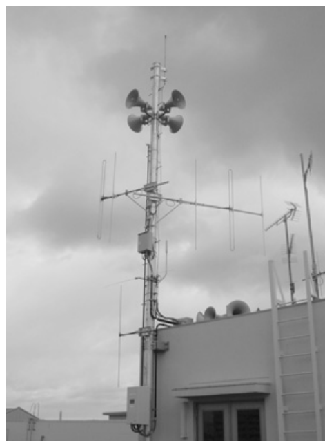
防災行政無線（本庁舎屋上）
