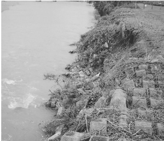
損壊した護岸
