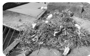
水路に投棄されたゴミや枯草
