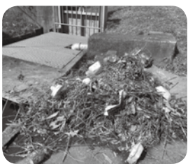
水路に投棄されたゴミや枯草
