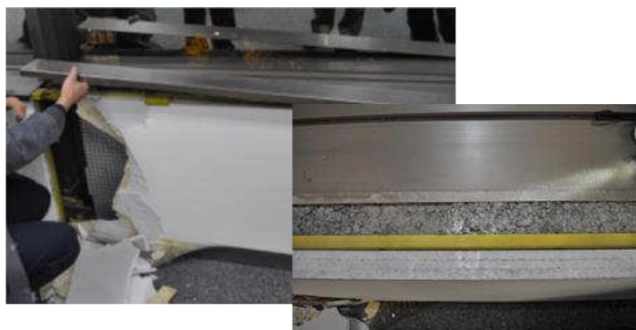
カーテンウォールの結露防止
