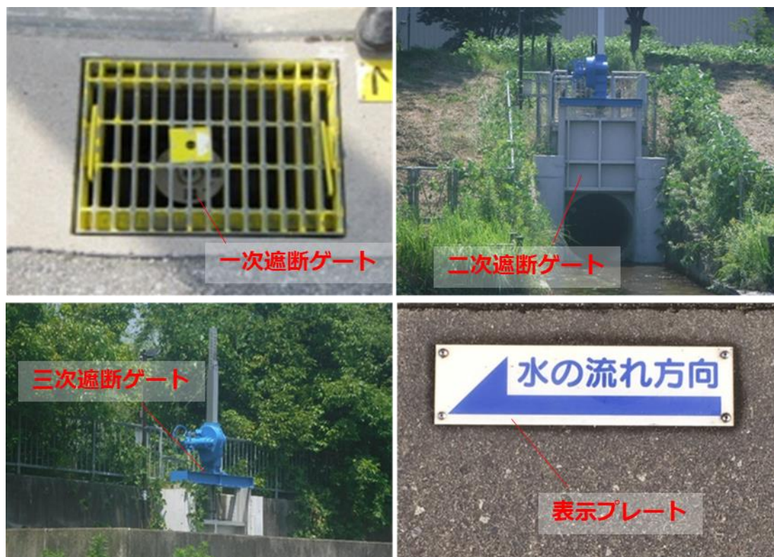
図. 種々の遮断ゲートと流れ方向の表示プレート
