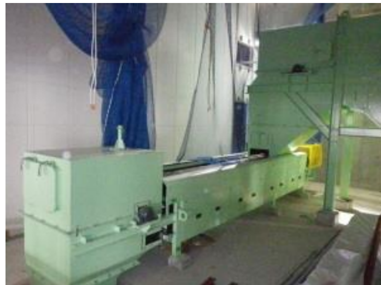
ペットボトル手選別コンベヤが 2 階に設置されました。
