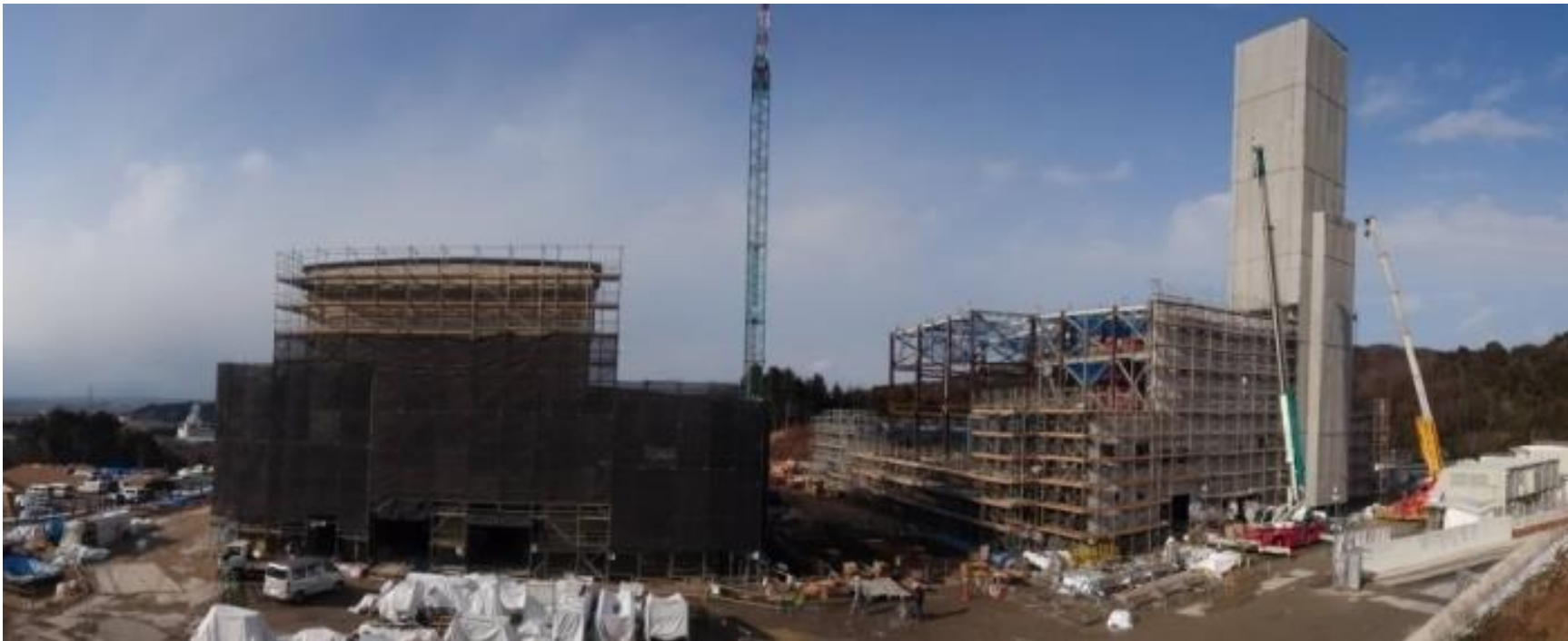
新野洲クリーンセンター建設工事現場の状況(平成 28 年 2 月末時点)
