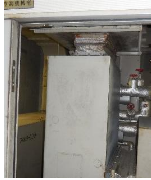
【空調設備 屋内】
