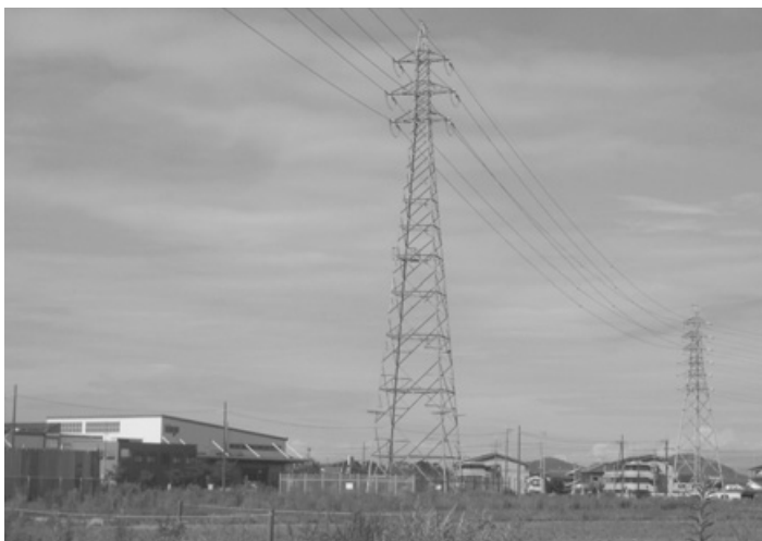
工業団地内鉄塔
