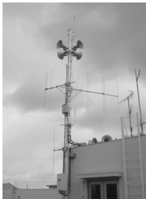
防災行政無線（本庁舎屋上）
