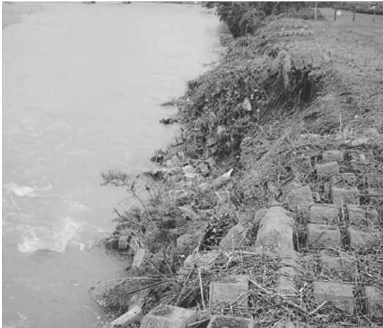
損壊した護岸
