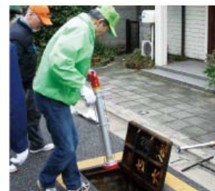
消火栓に差し込む
