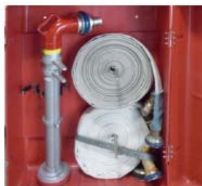
スタンドパイプとホース
