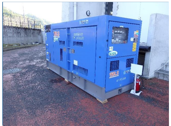
テント用大型発電機(蒲生体育館)
