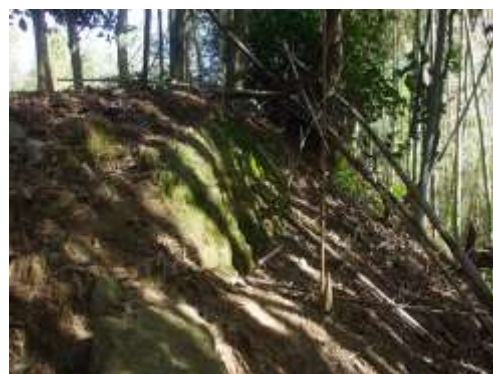
図 4.4 西側土塁（崩落危険箇所）：写真 D
