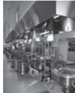
新設した野洲市学校給食センター調理室
