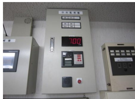
■電力デマンド監視装置
